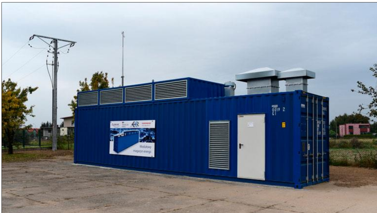
Zdjęcie 9 Przykład magazynu energii
