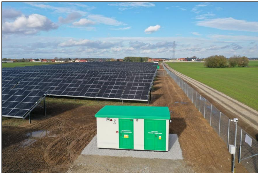
Zdjęcie 12 Plac pod stacją trafo.
