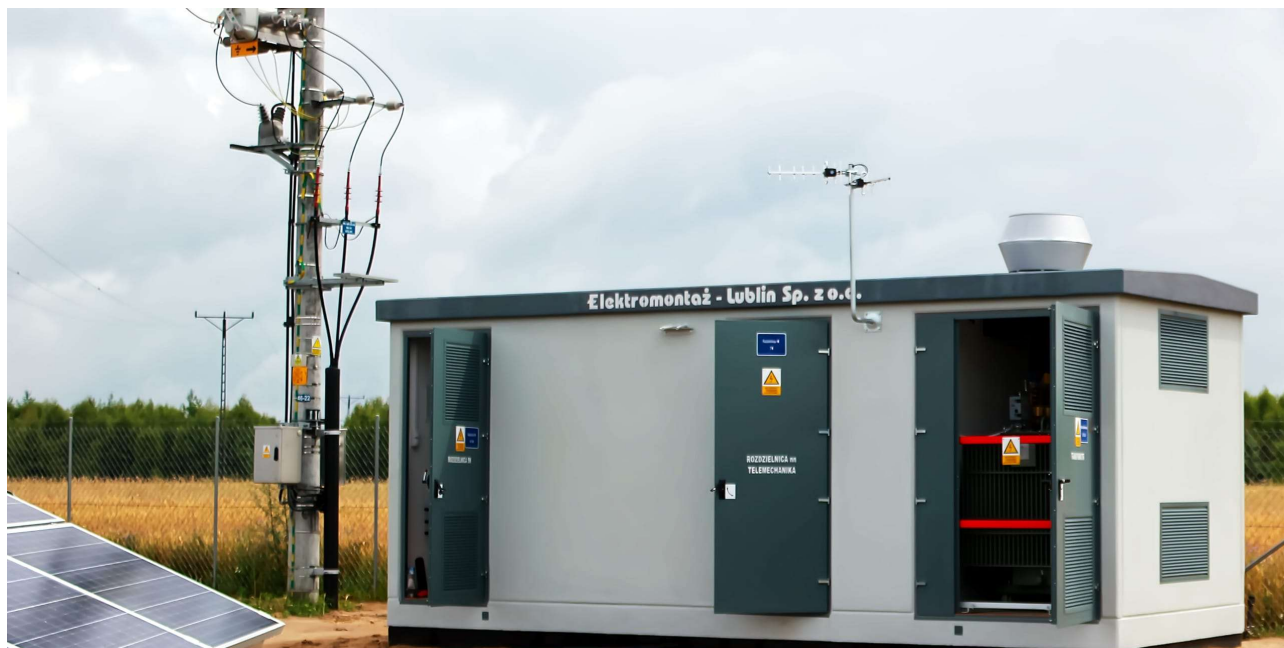
Rysunek 8 - przykładowa kontenerowa stacja transformatorowa na farmie fotowoltaicznej (źródło: https://elektromontaz-lublin.pl/ )
