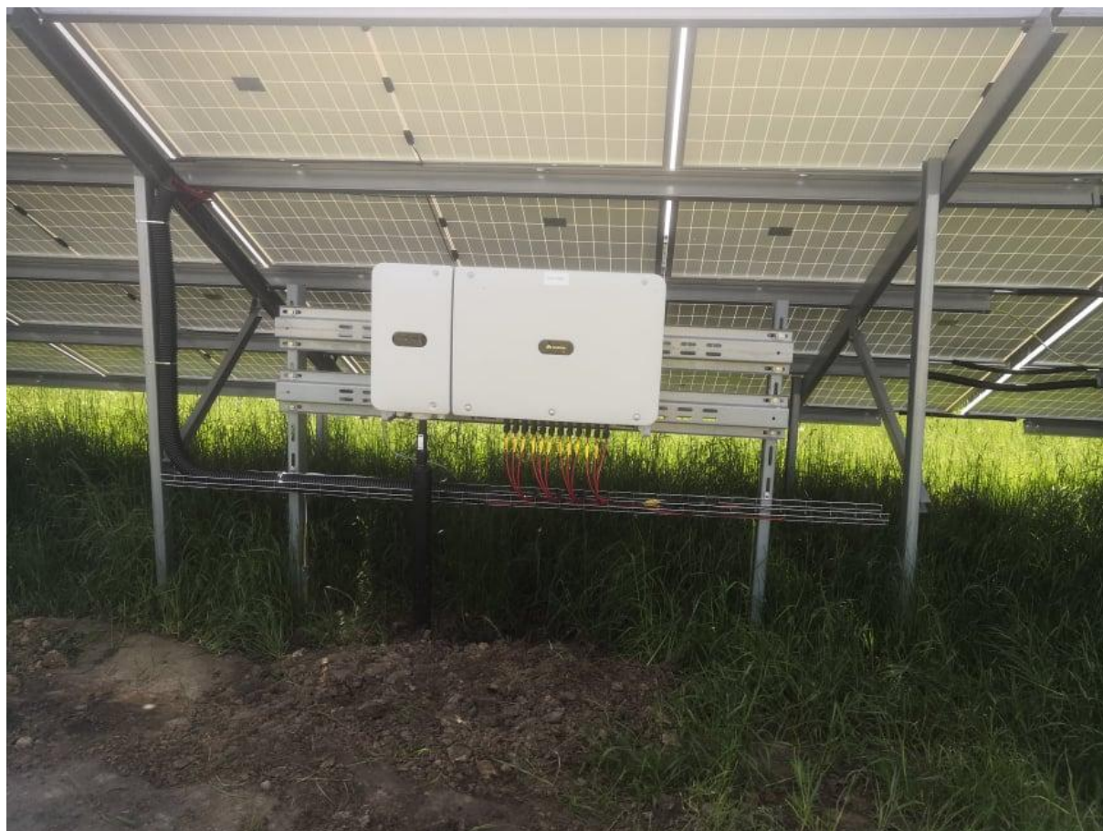
Rysunek 4. Falowniki (inwertery) zainstalowane na konstrukcji wsporczej.
