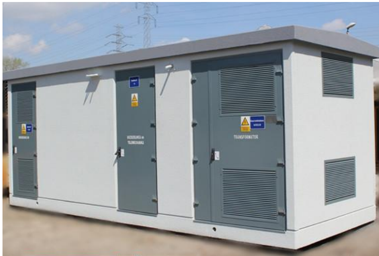
Rys. 3.3. Przykładowa stacja transformatorowa
