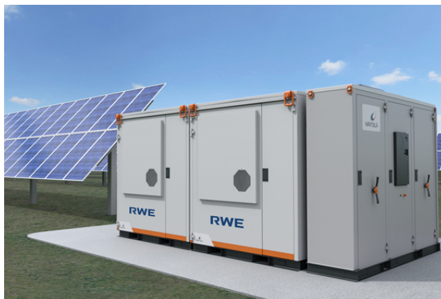
Rys. 3.4. Przykładowy magazyn energii
