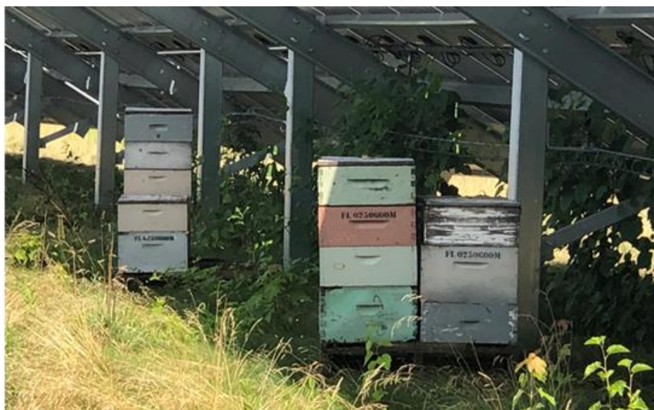
Fot. 5 Na terenie farm fotowoltaicznych coraz częściej rozwija się pszczelarstwo (Źródło: https://cleantechnica.com/2019/08/12/solar-power-is-playing-a-growing-role-to-save-the-bees-cleantechnica-exclusive/ )
