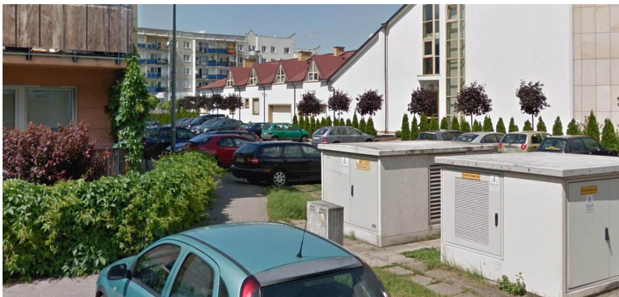
Rycina 10. Standardowa stacja kontenerowa w otoczeniu zabudowy.
