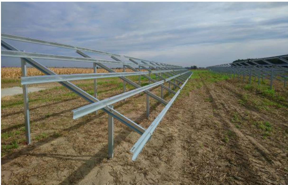
Rycina 4. Konstrukcja stała przeznaczona do posadowienia paneli fotowoltaicznych.
