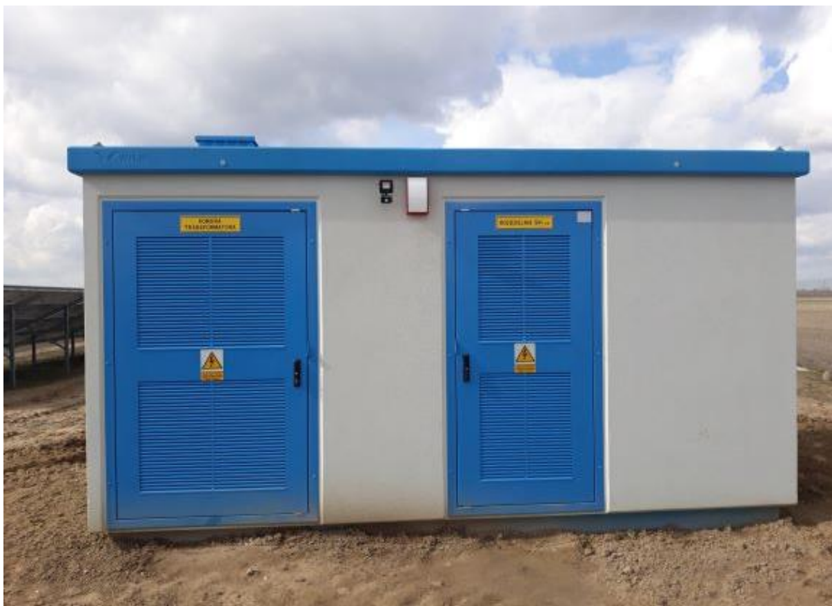
Rycina 9. Przykładowa stacja transformatorowa.
