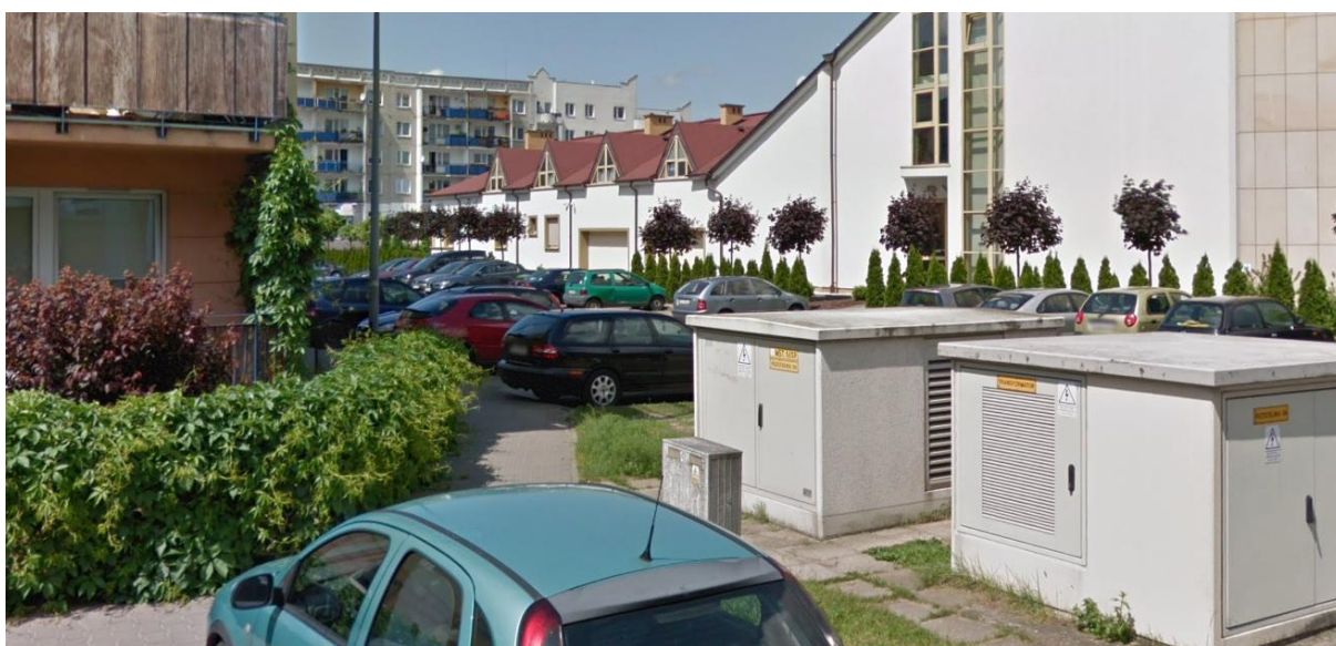
Rycina 11. Standardowa stacja kontenerowa w otoczeniu zabudowy.
