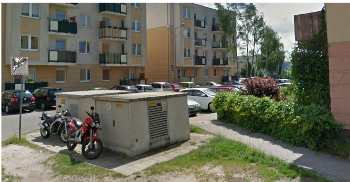
Rycina 12. Stacje transformatorowe w otoczeniu zabudowy mieszkaniowej.
