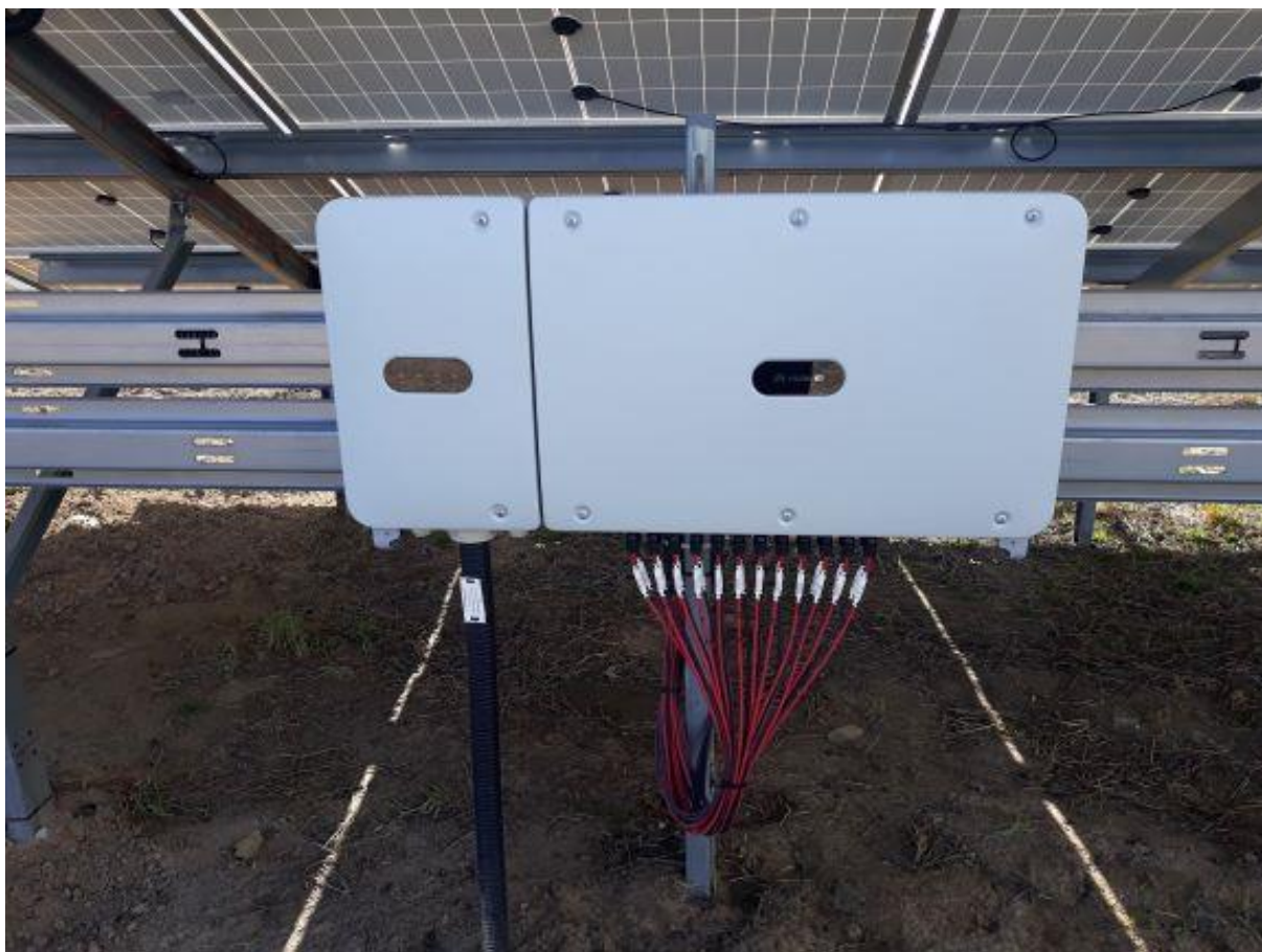
Rycina 9. Przykładowy inwerter farmy fotowoltaicznej.
