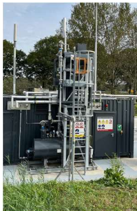
CO 2 -Reboiler Skid
